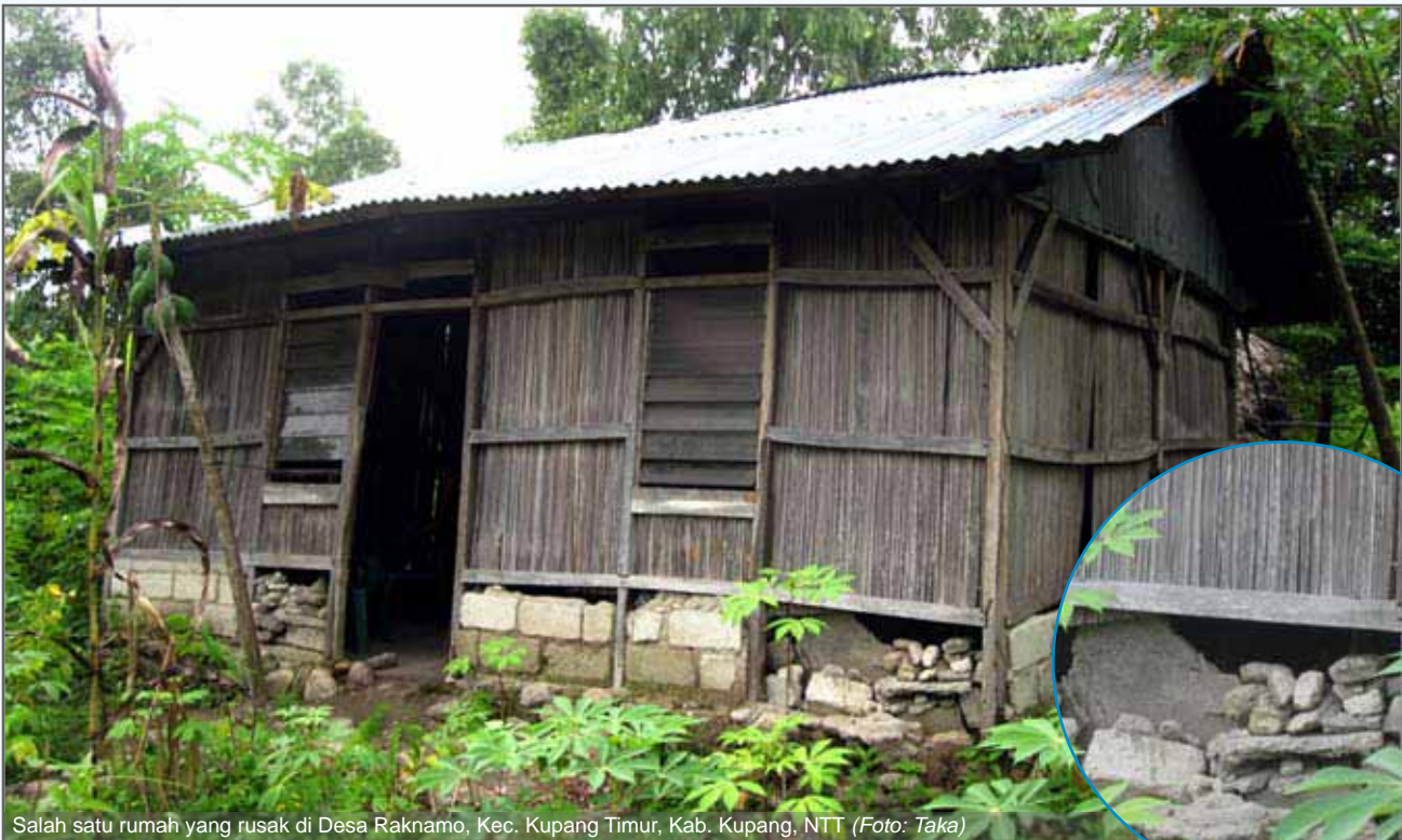
Salah satu rumah yang rusak di Desa Raknamo, Kec. Kupang Timur, Kab. Kupang, NTT (Foto: Taka)
